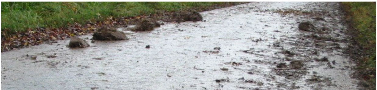
Bild 35: starke Verschmutzung von Radwegen sofern sie die Befahrbarkeit behindern oder ein Unfallrisiko bedeuten
