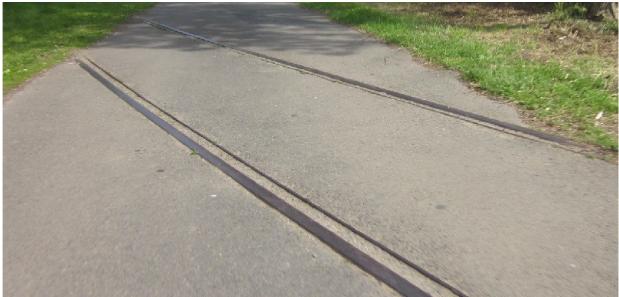
Bild 22: Schräg querende Rillen (Bahnschienen), Entschärfung unbedingt notwendig
