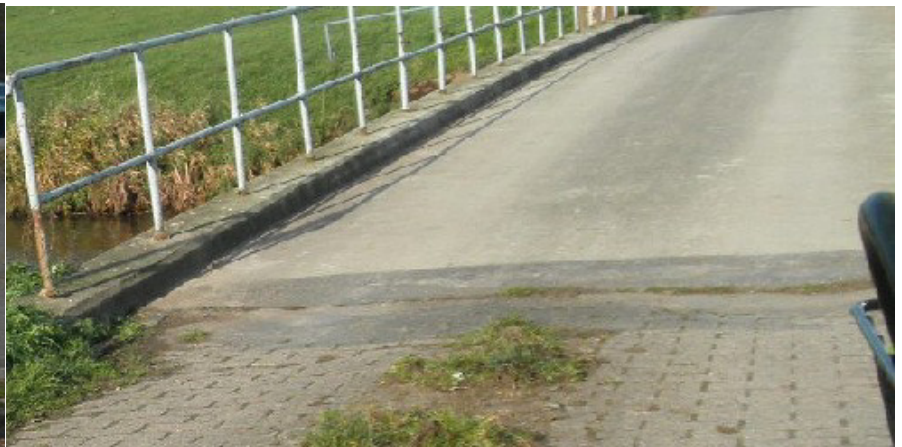
Bild 24: Absatz in Fahrbahnen (rechts)
